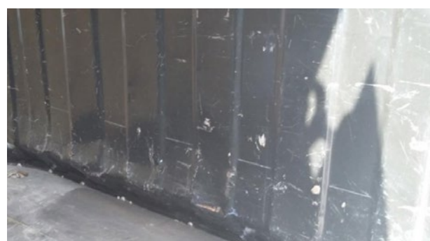
Deformazioni interne: Leggera deformazione senza perforazioni o tagli, tempo di riparazione ≤ 3 h
