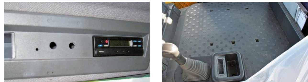
Componenti di comando, componenti del sedile o del rivestimenti mancanti, rotti o forati
