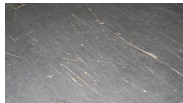
☰ Pavimentazione: leggera deformazione, usura superficiale
